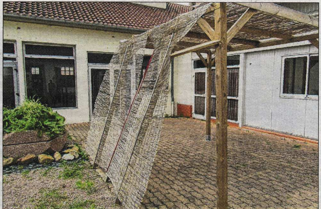
Installée par les bénévoles de l'association, la pergola abritait la terrasse du restaurant.
